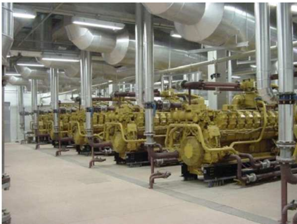
Figura 51 Grupo Geradores, Motor a Biogás ciclo Otto de Alta Potência.
