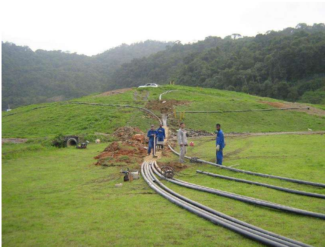
Figura 24 Vista de implantação de linhas de Biogás no Aterro Sanitário Terrestre
