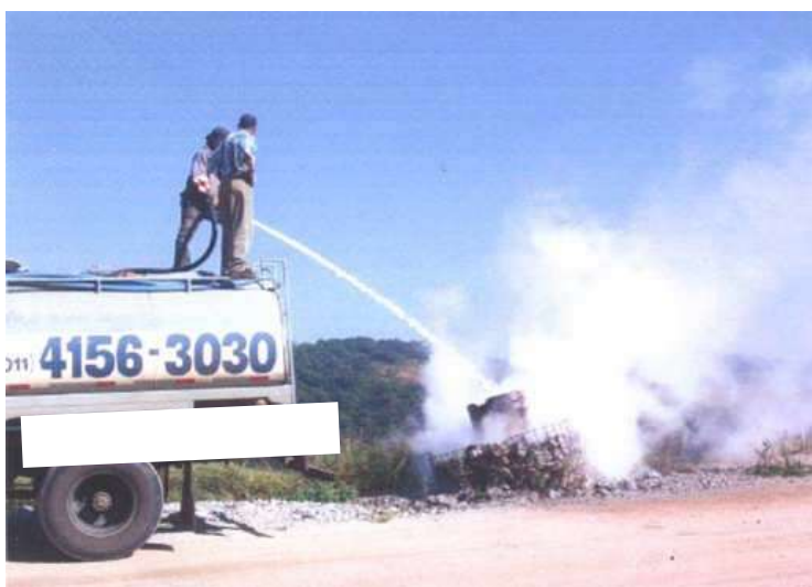
Figura 29 Vista de Encerramento de fogo em Dreno Vertical por água. Fonte: DELBIN, 2004.
