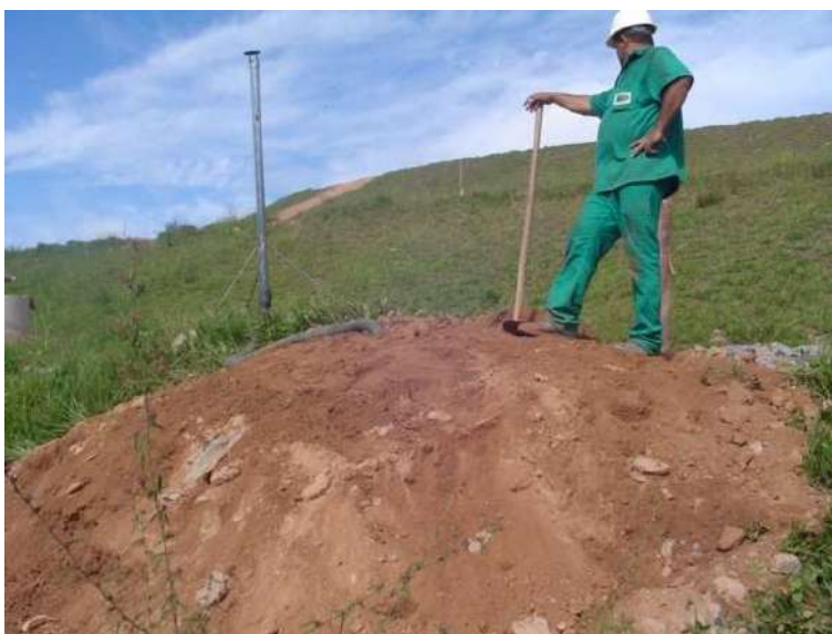
Figura 31 Vista de tocha provisória implantada.
